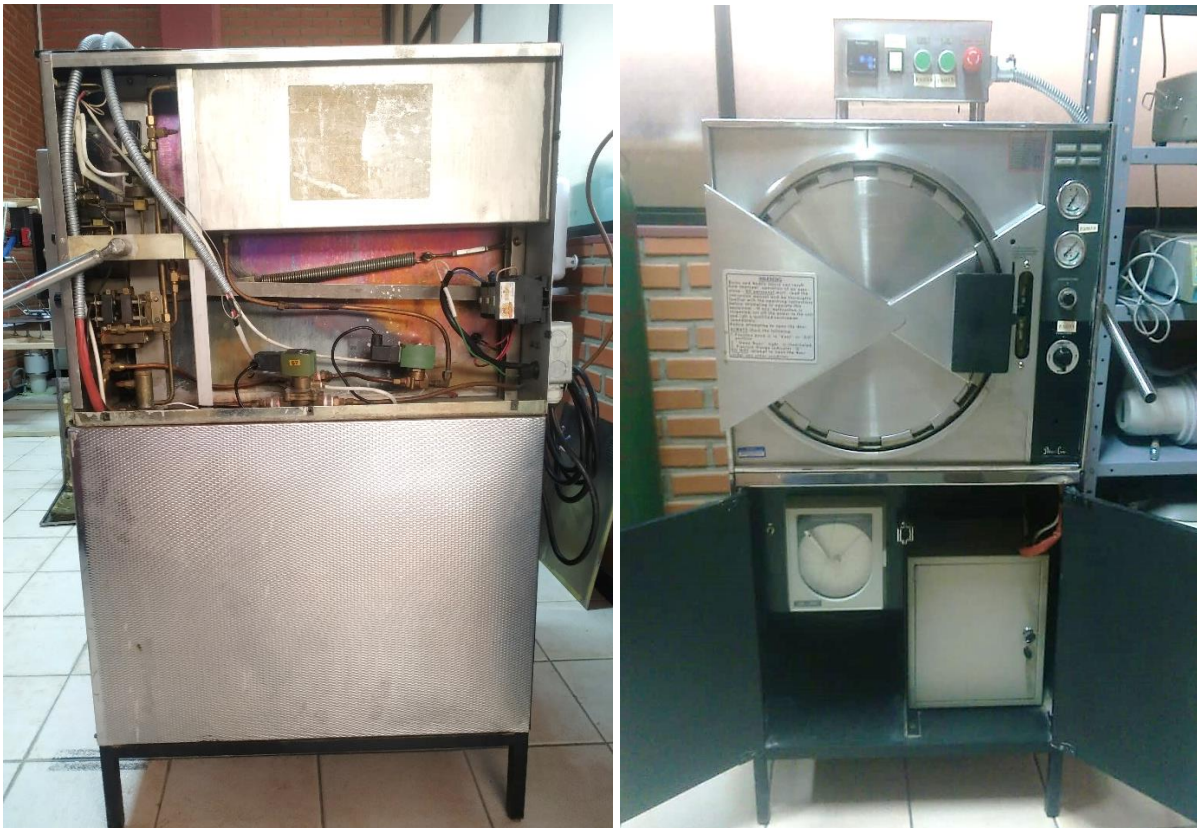
Figura 2.2. Estado inicial de autoclave de laboratorio.
